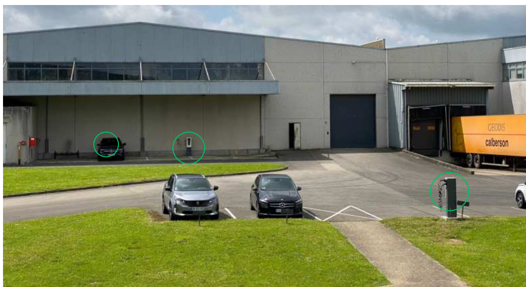
5 bornes de recharge pour véhicules électrique
