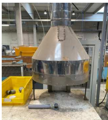
Système d'aspiration de la colle pour pour l'assemblage des flexibles souples
