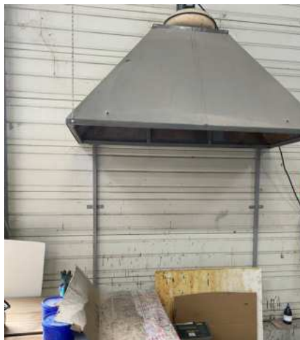
Système d'aspiration des émanations du coulage de la résine ardoise
